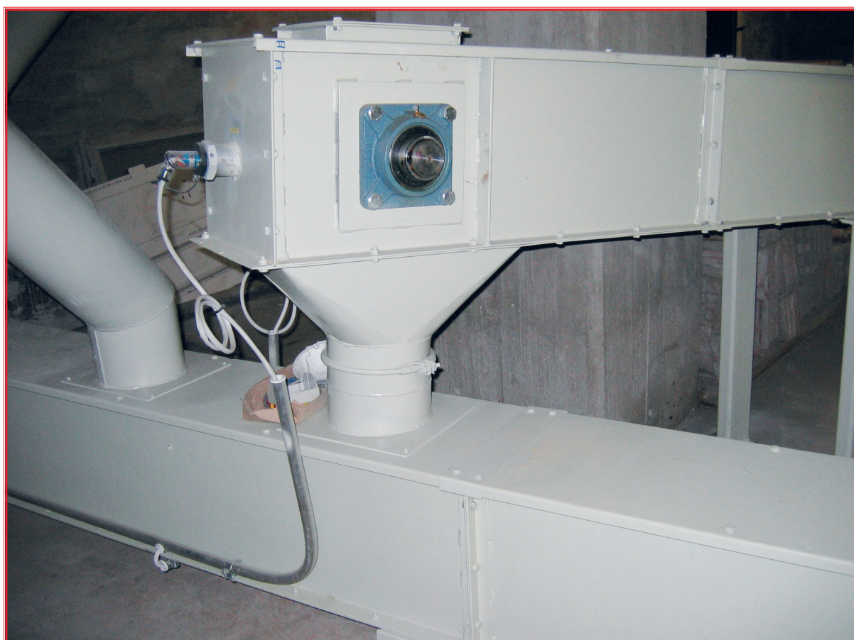
Kuva 2. Kuljettimen vetopään päädyssä ruuhkavahti. Vaihdemoottori toisella puolella.
