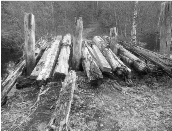
Puunkuljettajan painajainen. 1960-luvun sillan kansi on lahonnut ja routa nostanut kannatintolpat ylös.
