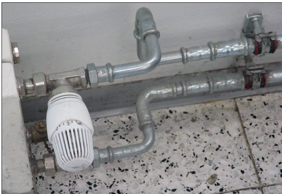
Kuva 42. Vuonna 1998 asennettu termostaattinen patteriventtiili. Kuva: Tapio Korkala.
