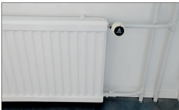
Kuva 36. Levyradiaattori 1970-luvun rakennuksessa. Kuva: Mika Petäjä.
