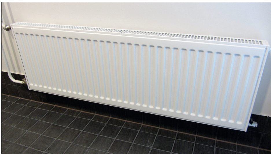
Kuva 37. Vuonna 2016 asennettu nykypatteri asuinrakennuksessa. Kuva: Kiinteistömedia Oy.
